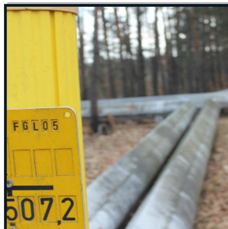
Über solche Leitungen wurde bisher die Abwärme aus dem Kraftwerk Boxberg als Fernwärme nach Weißwasser/O.L. transportiert.
